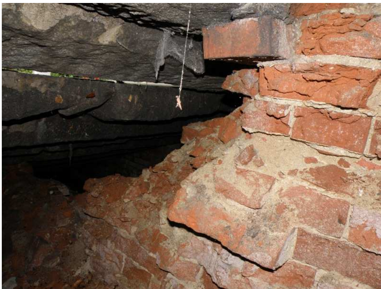
Widoczny zupełny brak podparcia stopnic
