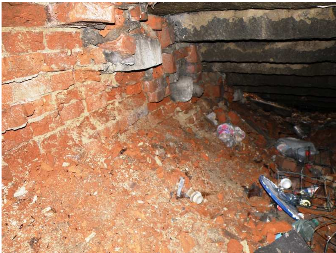
Wykruszone na ponad \frac{1}{2} cegły lico ściany
