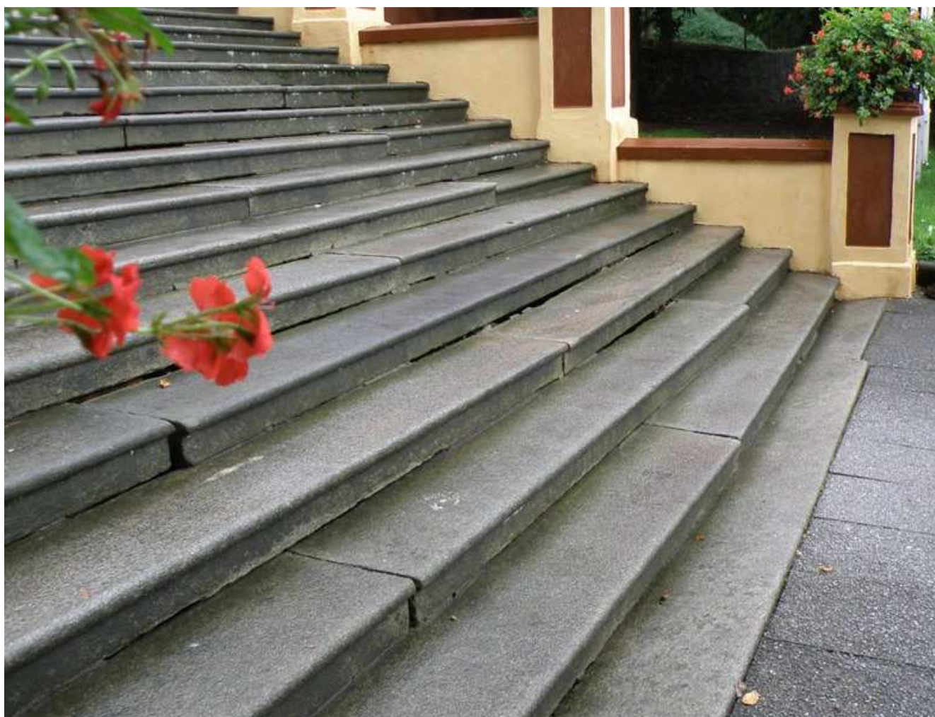
Deformacje schodów kamiennych
