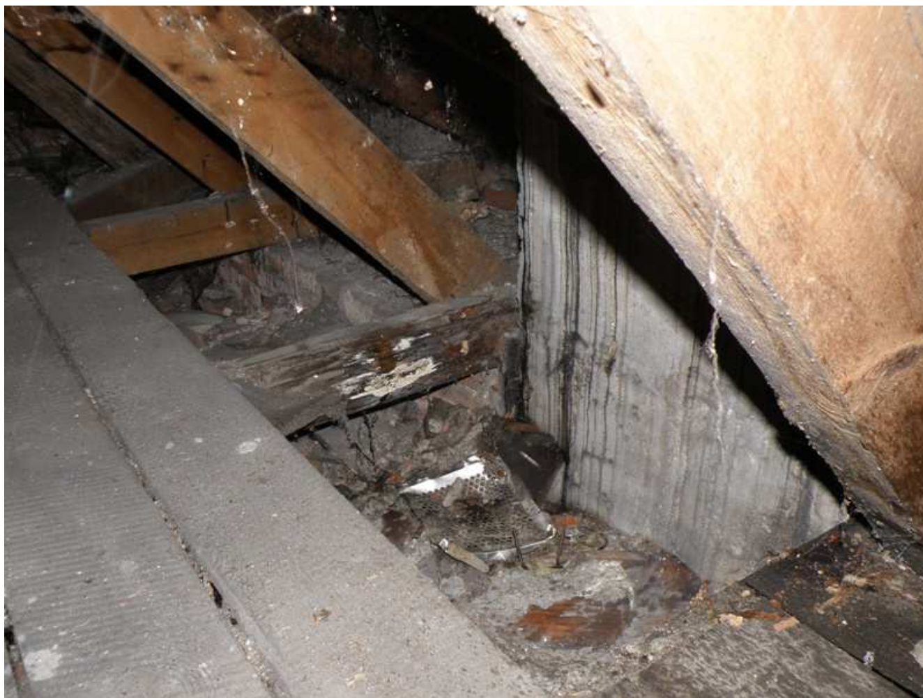
Zagrzybiona belka pod podłogą
