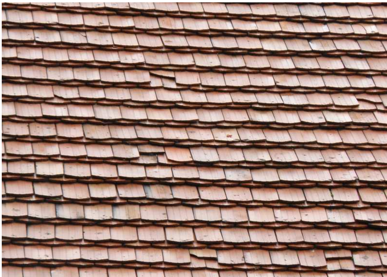
Zniszczona powierzchnia dachówek
