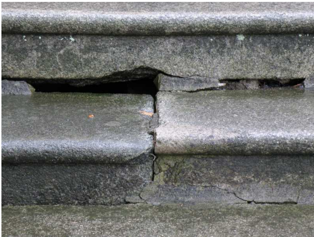
Ubytki w stopnicach kamiennych
