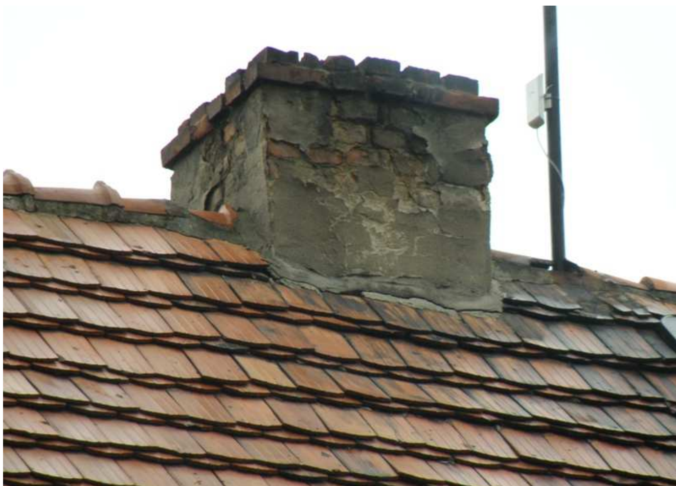
Zniszczona czapka kominowa i obsypujący się tynk
