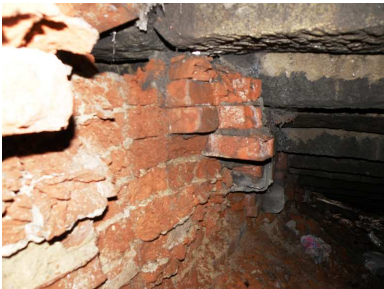
Widoczne ubytki ściany na prawie 1 cegłę
