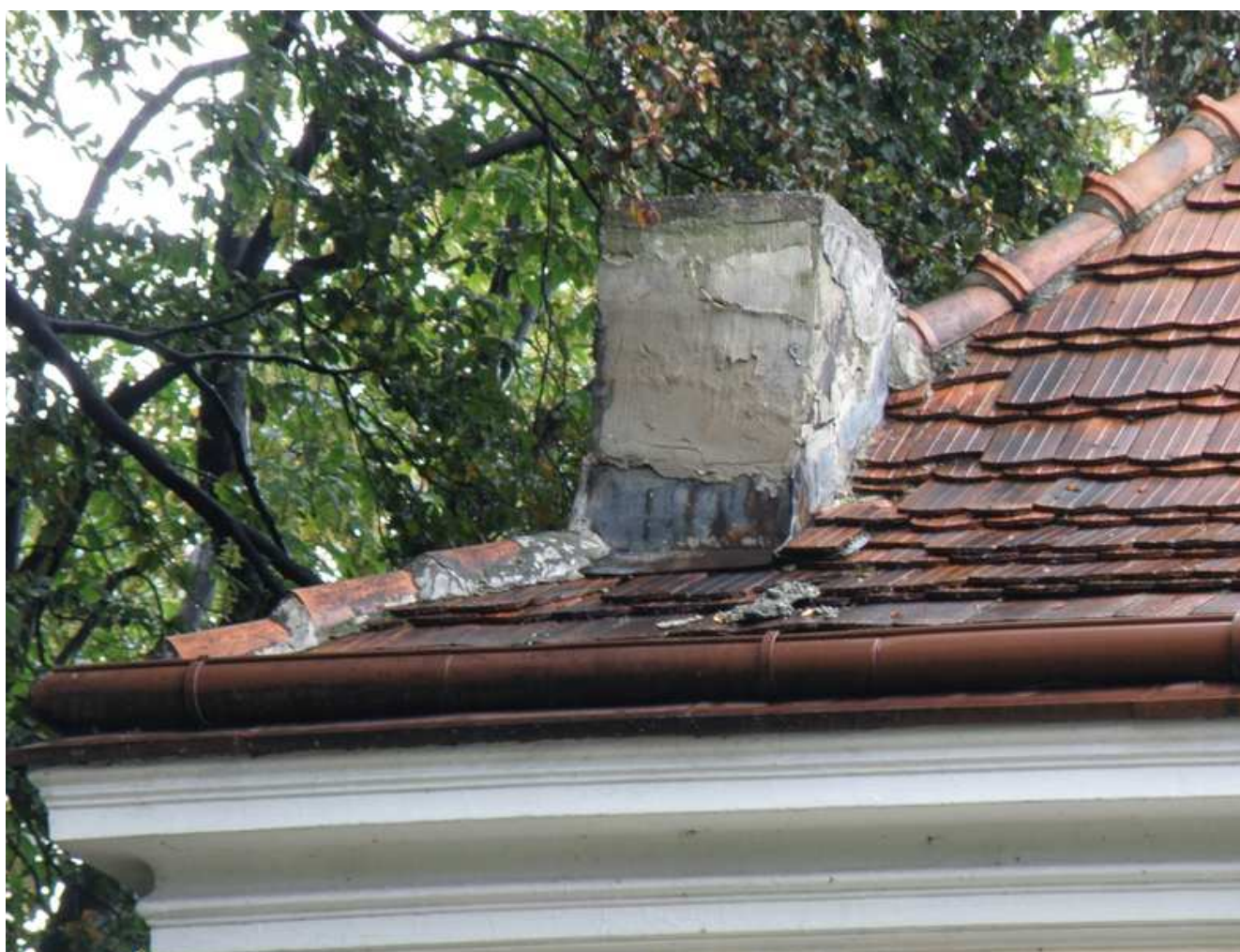
Komin po próbach remontu
