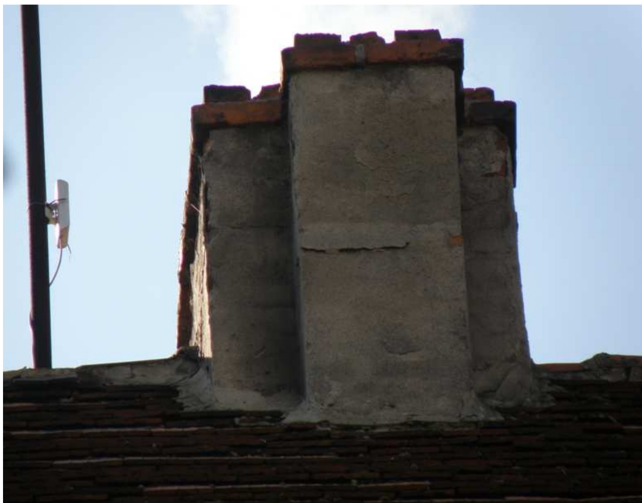
Zniszczona czapka kominowa i obsypujący się tynk
