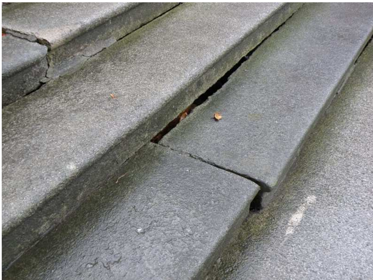
Przesunięte stopnice schodów zewnętrznych
