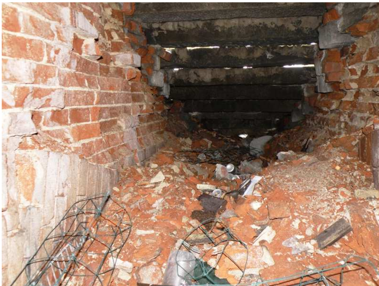
Ubytki ścian podpierających schody
