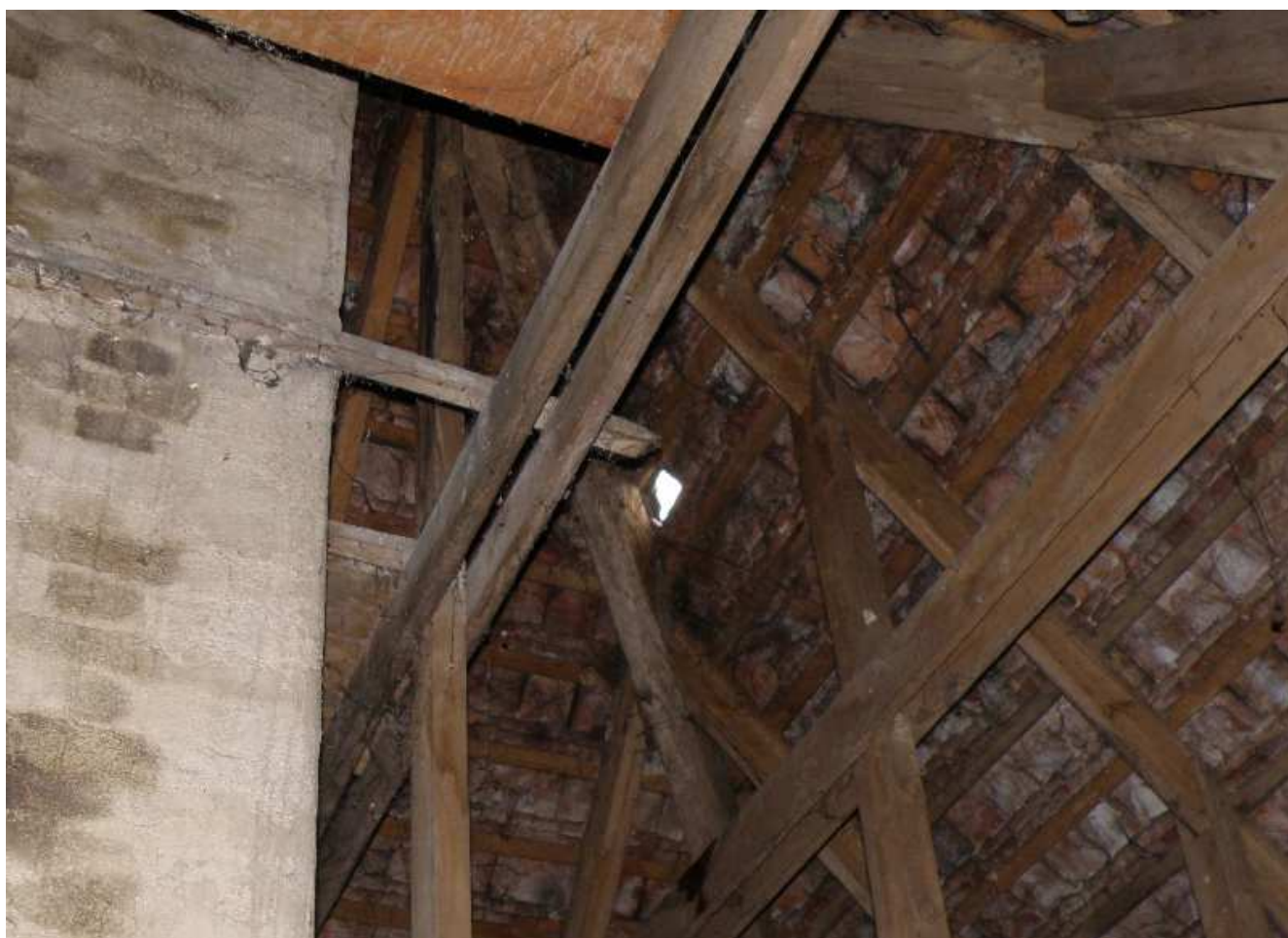
Dziura w pokryciu dachowym
