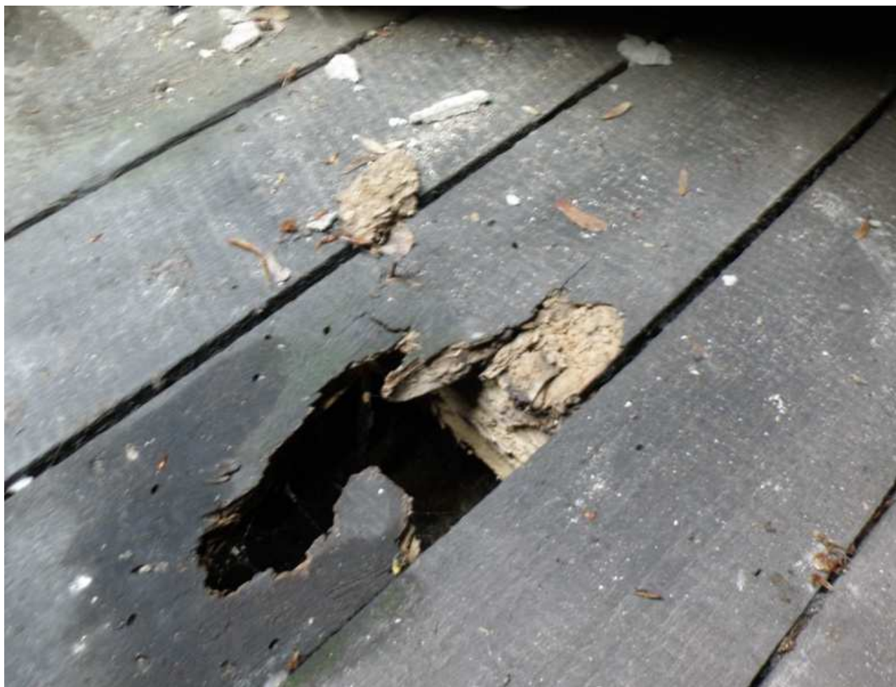
Zagrzybiona podłoga na strychu i znajdująca się pod nią belka
