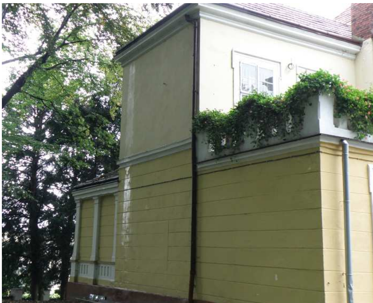
Lejąca się woda po ścianie przybudówki
